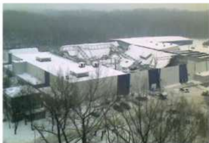
Hala Międzynarodowych Targów Katowickich po zawaleniu się dachu 28 stycznia 2006 r.
