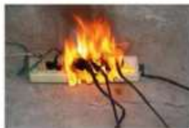
Zwarcia instalacji elektrycznej
