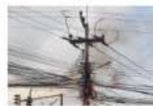
prąd elektryczny (np. zerwana linia energetyczna)
