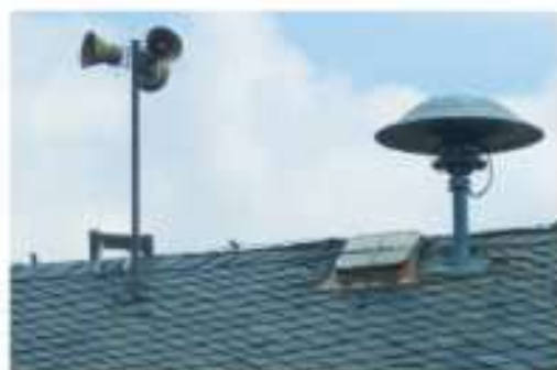
Syrena alarmowa na dachu budynku
