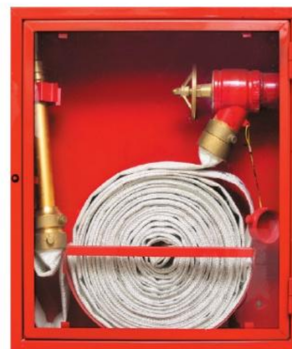
Zdjęcie nr 62. Hydrant wewnętrzny
