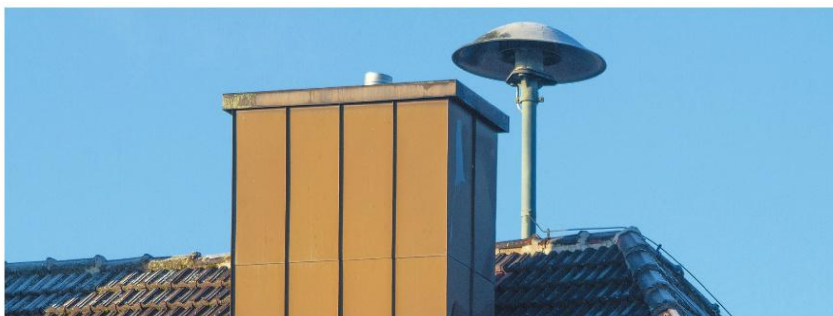
Zdjęcie nr 43. Syrena alarmowa na dachu urzędu miejskiego
