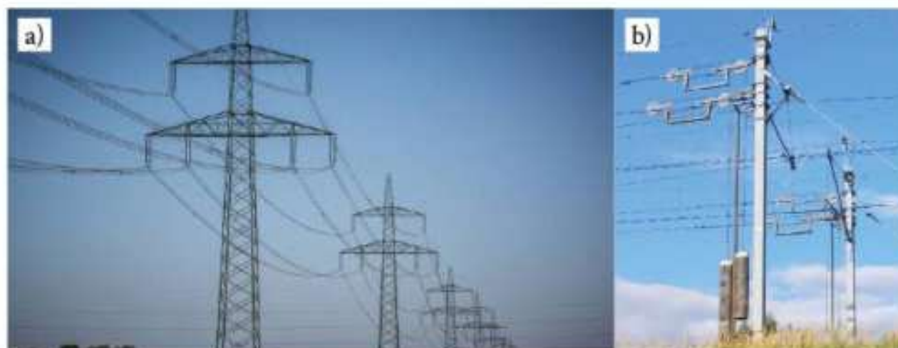
Rys. 6. a) W linii wysokiego napięcia w lecie przewody zwisają luźno, dzięki czemu podczas mrozów się nie zrywają. b) Urządzenie do napinania przewodów w sieci trakcyjnej gwarantuje, że przewód jezdny znajduje się na właściwej wysokości niezależnie od temperatury otoczenia.
