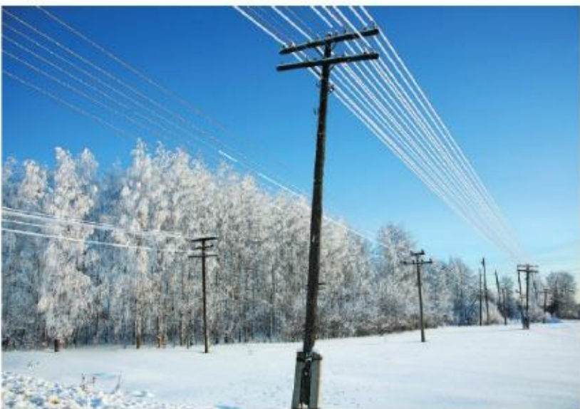
3.9 Linia sieci wysokiego napięcia zimą
