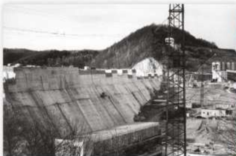
Ryc. II.7.3. Rozbudowujący się przemysł ciężki potrzebował znacznych ilości energii elektrycznej. Dlatego budowano wiele nowych elektrowni, jak ta w Solinie.
